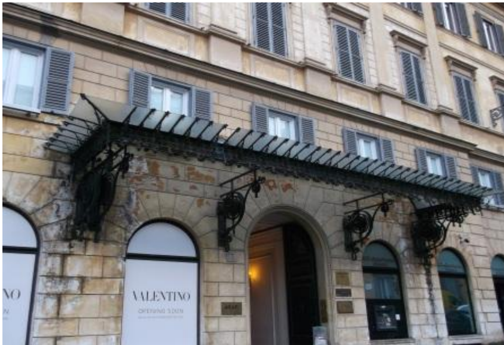
Uffici e negozio Valentino– P.zza di Spagna Opere di risanamento strutturale e finiture interne
