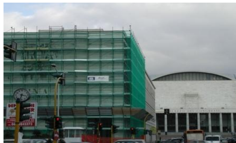
Ministero della ricerca scientifica – Piazzale Kennedy 20 – Roma EUR Ristrutturazione interna ed esterna – Edificio sottoposto a tutela
